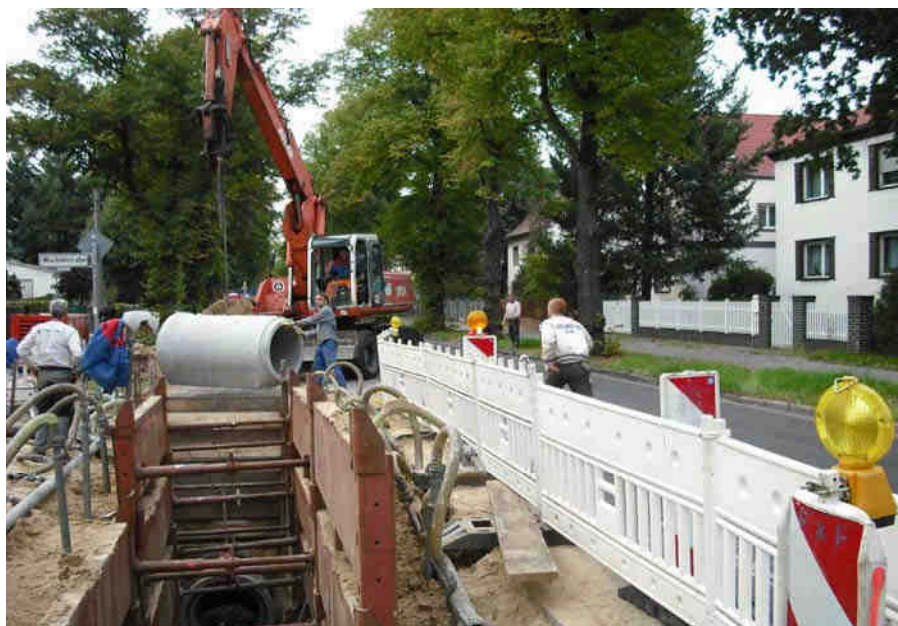
Abb. 16: Verbau mit Grundwasserabsenkung. Havarie mit Unterhöhung und Einbruch der Straße. Betonrohre mit DN 900 werden in offener Bauweise ausgewechselt.
