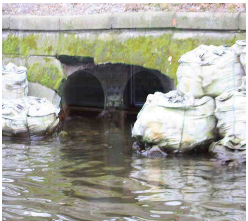
Abb. 7: Einleitungsstelle aus einem Regenüberlauf im Landwehrkanal 2010 (Photo: privat)
