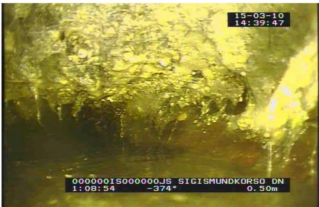
Abb. 18: Das Bild zeigt einen Abwasserkanal mit bis zu 60 % iger Fettablagerung, Quelle: Firma Frisch & Faust Tiefbau GmbH
